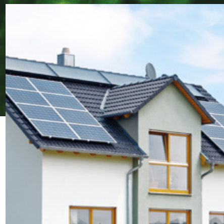
MODUŁY I INWERTERY FOTOWOLTAICZNE
